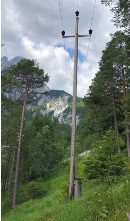
Einer der Masten der 30 kV-Freileitungstrasse nach Johnsbach
