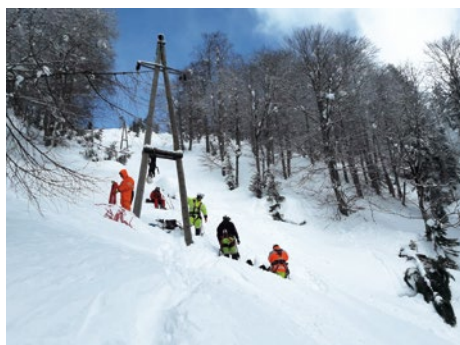
Nur mit Hilfe der Bergrettung konnten die Schäden am Versorgungsnetz behoben werden
