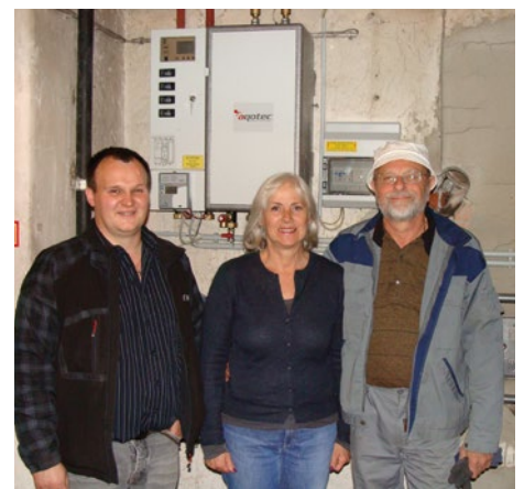
2012 Christian Kovacs (links) übernimmt im Juni die Betriebsführung der Fernwärme Admont. Fünf Monate später kann er bei der Fam. Drusowitsch den bereits 150. Hausanschluss übergeben.
